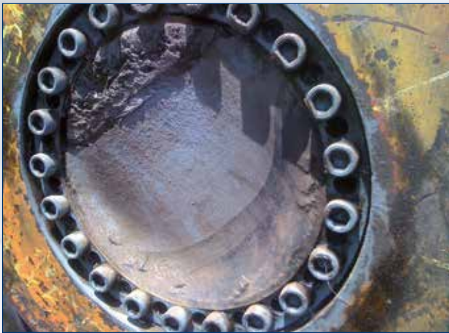
Wellenbruch · Shaft breakage
